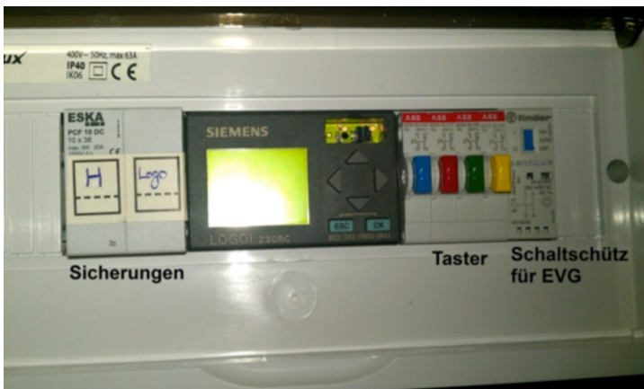
Abb. 1: Schaltkonsole mit Siemens LOGO! in Standard-Sicherungskasten mit Hutschiene
